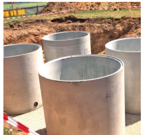
Einbau der Regenwasserzisternen am Gelände des SV Plech e.V.; Foto: F. Schuster
