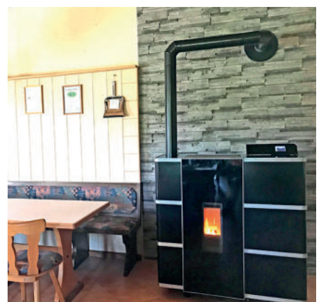
Der neu installierte Pelletofen im Vereinsheim des Plecher Heimatvereins; Foto: A. Heisinger
